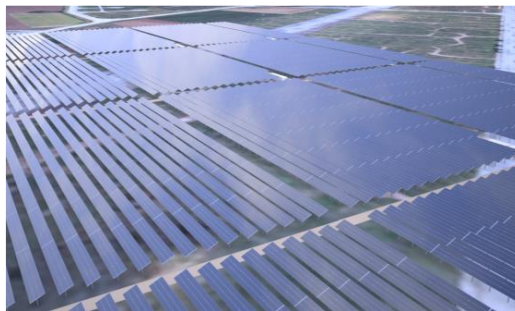
Vue aérienne de la centrale photovoltaïque
